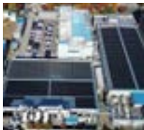
천안캠퍼스 태양광 발전 설비
