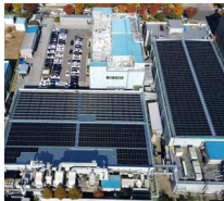
천안캠퍼스 태양광 발전 설비
