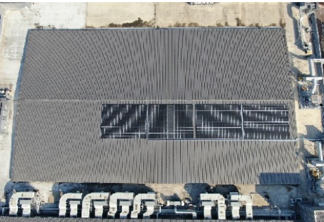
아산캠퍼스 태양광 발전 설비
