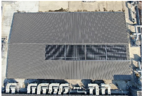
아산캠퍼스 태양광 발전 설비
