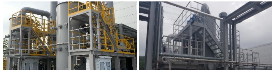
하나머티리얼즈 사업장 내 Scrubber
